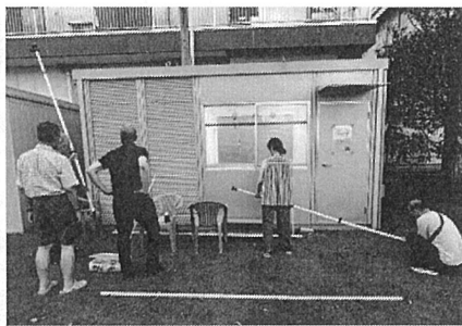
【南部地区ボランティアセンター開設準備】
